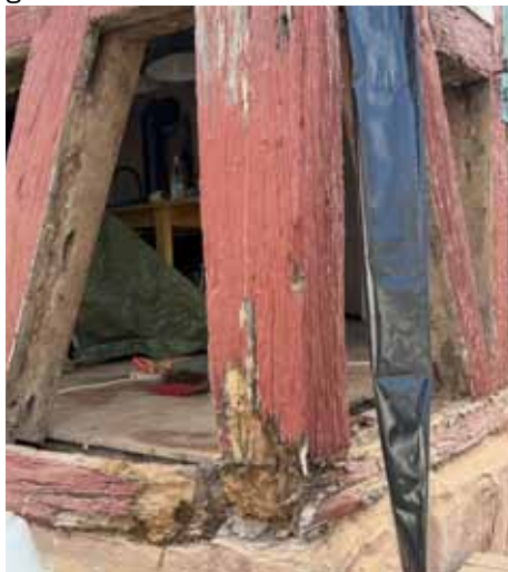
Fäulnissschaden an Gebäudeecke
